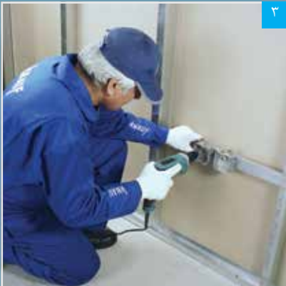
اتصال قوطی برق به سازه پشتیبان
