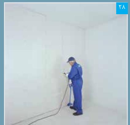
اجرای لایه دوم پنل ها؛ ساختار W112 (لایه دوم نسبت به لایه اول به صورت حصیر چین اجرا می شود)
