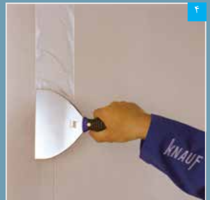
۴ مرحله اول درزگیری: اجرای لایه بتونه در محل درز (کاردک در جهت عمود بر درز کشیده می‌شود تا بتونه کاملاً در درز نفوذ کند)
